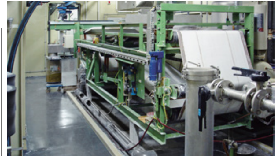
Bandfilter einer Sprengstoffausspülanlage
